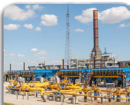
КОМПРЕССОРНАЯ СТАНЦИЯ ПО ПЕРЕГОНУ ГАЗА 2022г., с.ЕЛШАНКА
